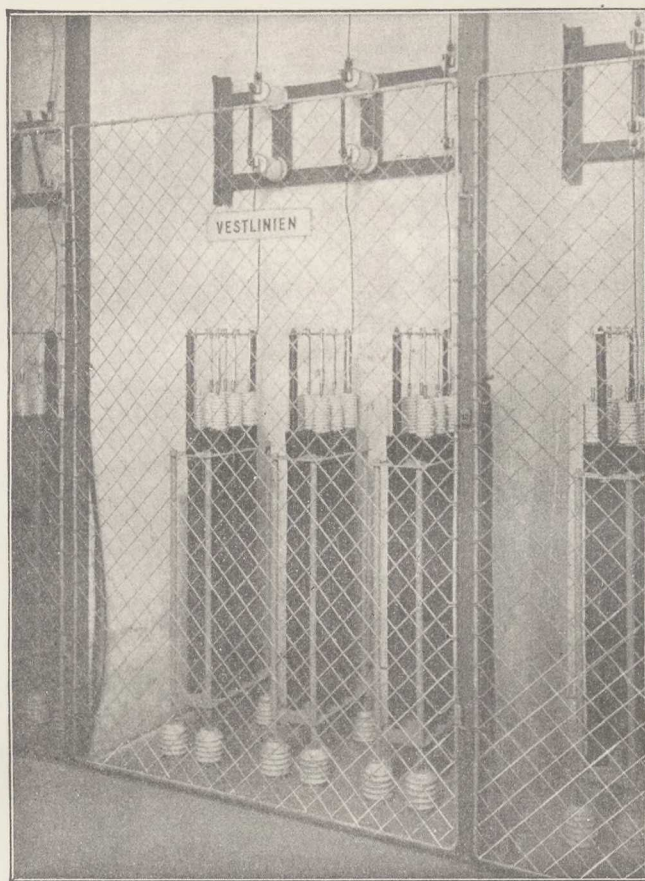
FIG. 158 KONDENSATORBATTERI. N.V. SJÆLLANDS EV.
