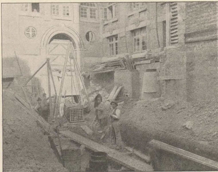
49 Huls Kabelblokke ved den nye Central.
